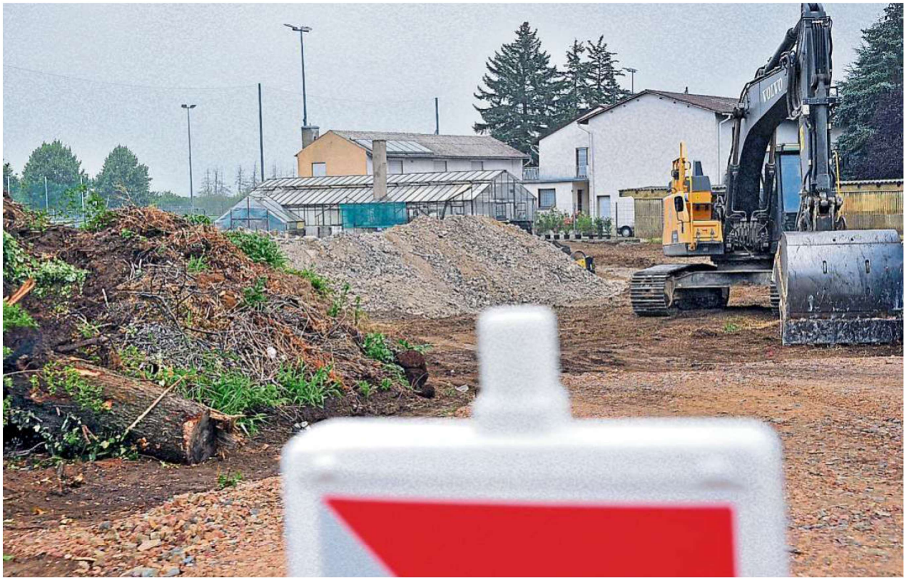
Seit wenigen Tagen laufen die Vorbereitungen für die Bauarbeiten am Ortsausgang von Gau-Algesheim.
