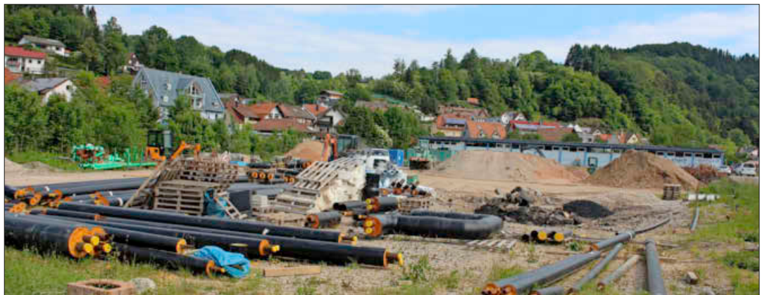
Hier, ganz nah beim Elzacher Schwimmbad, will die Lebenshilfe bauen. Bis es soweit ist und schon seit geraumer Zeit ist das Gelände der früheren Glaserei Bayer Lagerplatz für die Elzacher Nahwärme-Genossenschaft.
